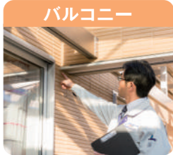
バルコニー バルコニーのひび割れ、劣化はないか
