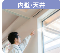
内壁・天井 内壁と天井の雨漏りの跡の確認
