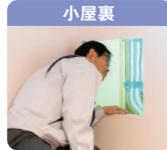
小屋裏 小屋裏の劣化状況の確認
