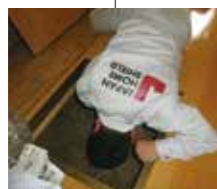
■ 土台のひび割れ、劣化
