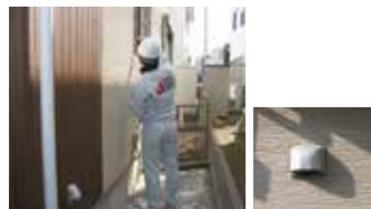
■ 外壁のひび割れ、欠損、はがれ、サッシの周囲の隙間、開閉不良
