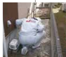
■ 基礎のひび割れ、欠損、劣化
