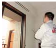
■ 内壁と天井の雨漏りの跡
