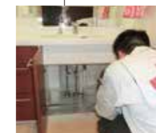
■ 室内(専有部) 床の傾斜・給排水管路
