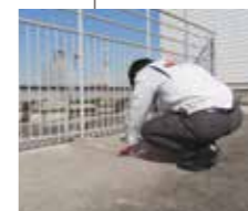
■ 屋上・屋根の防水層の劣化
