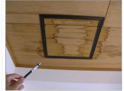
●居室の雨漏れ跡
