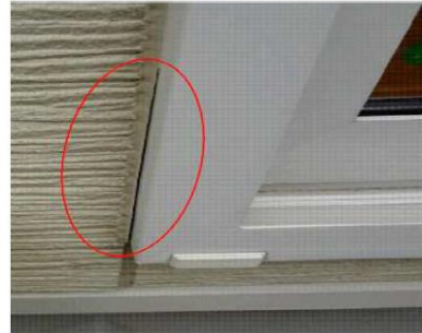
●シーリングの破断
